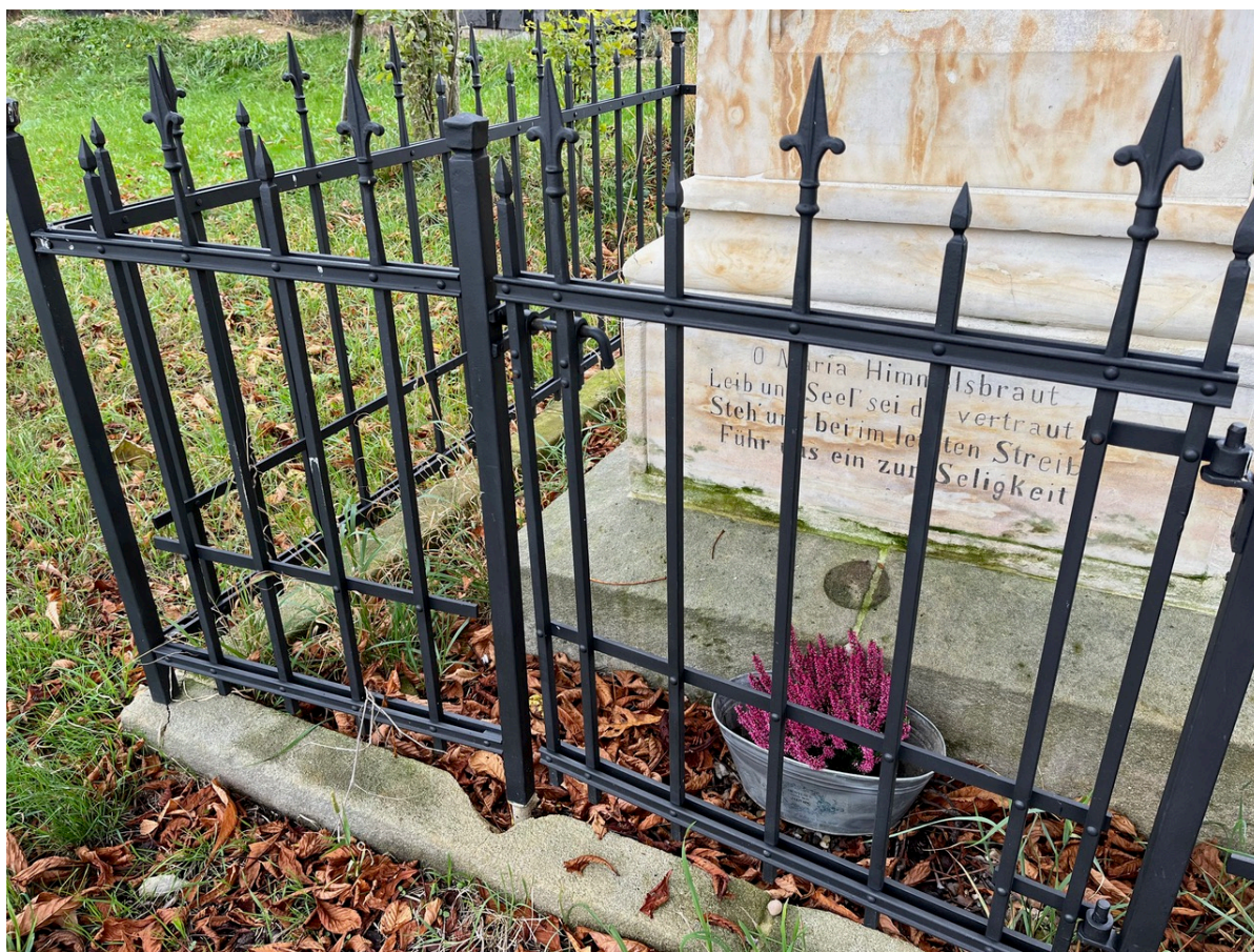
Příloha 2 - Foto poškozeného kovaného plotu u sochy p. Marie v Knapovci
