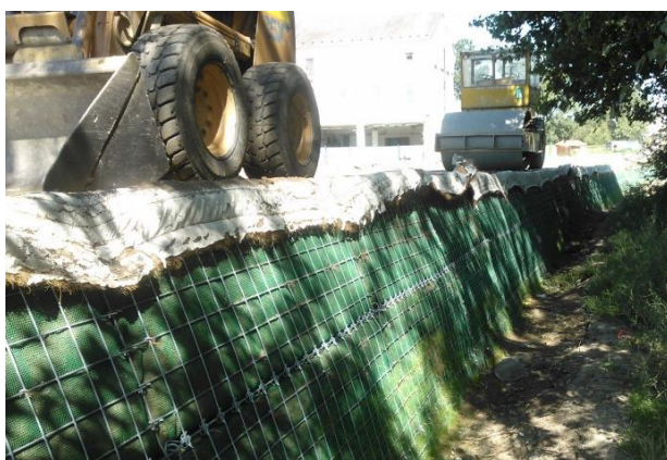
Obr. 51. Nepřípustný pohyb mechanizace
