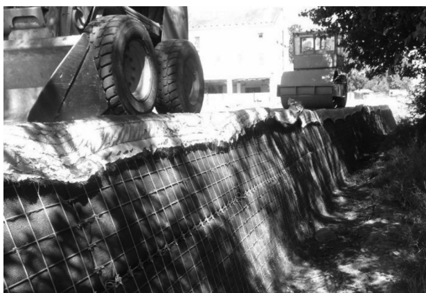
Obr. 51. Nepřípustný pohyb mechanizace
