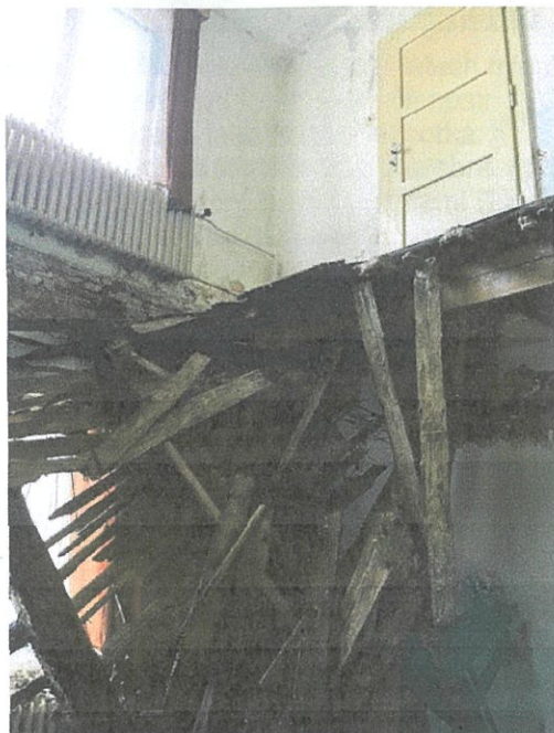
Fotografie č.3 Zborcená stropní konstrukce
