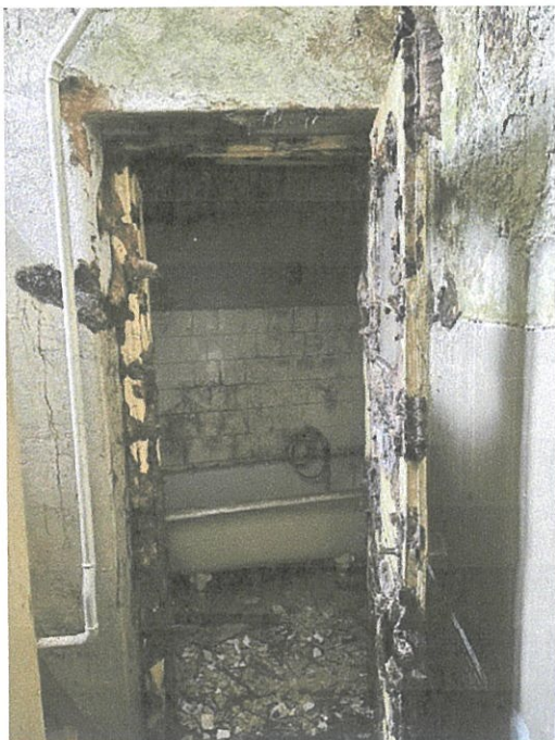
Fotografie č.4 Fyzický stav zařízení koupelny
