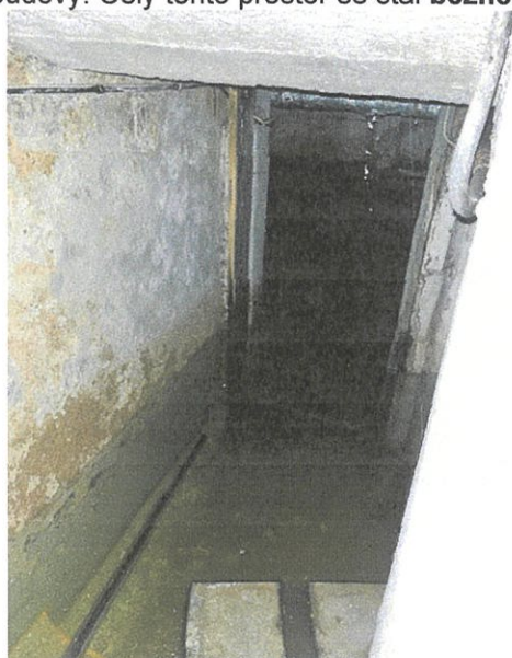
Fotografie č.2 Vniknutá voda ve sklepním prostoru
